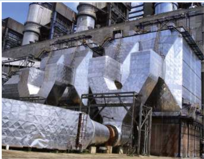
PP Obrenovac - ESP of Unit no. A6 - 350 MW
