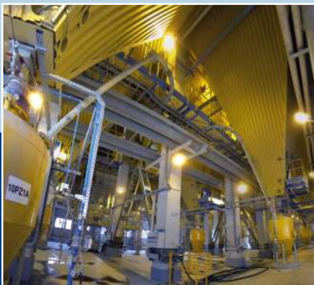
System pneumatycznego odpowielania – El. Kozienice, kocioł nr 10
