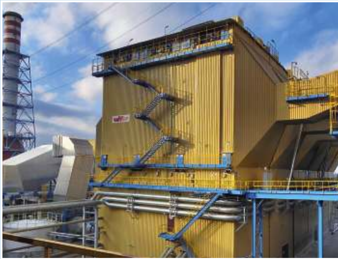
El. Kozienice – elektrofiltr kotła nr 10 - 560 MW
