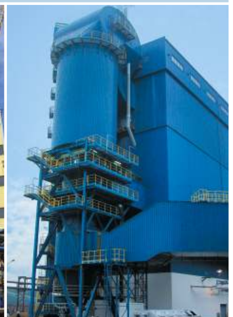
EC Łódź 4. Instalacja odsiarczania spalin metodą półsuchą
