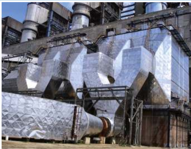
El. Obrenovac - Serbia – Elektrofiltr kotła nr A6 – 350 MW
