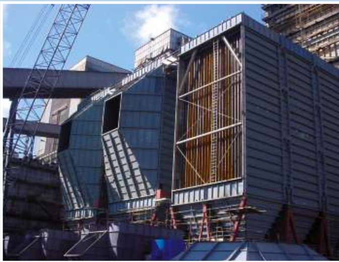
Elektrownia Tuzla – Bośnia i Hercegowina, 3 kotły OB-650, bloki 200 MW
